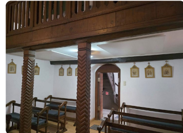
Dank eines Förderprogramms des Bistums Aachen wurde die Kapelle auf eine Bauteiltemperierung umgestellt.
